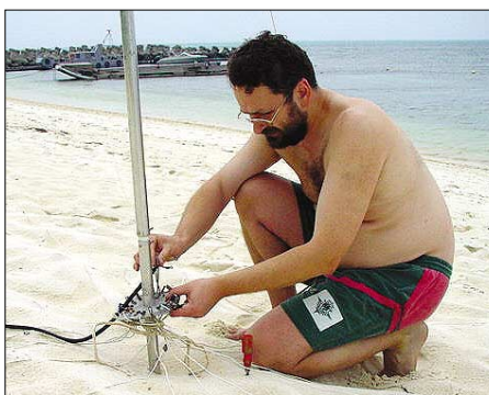
Falk, DK7YY, beim Aufbau der Butternut-Antenne HF6V, etwa 10 m entfernt vom Meer
